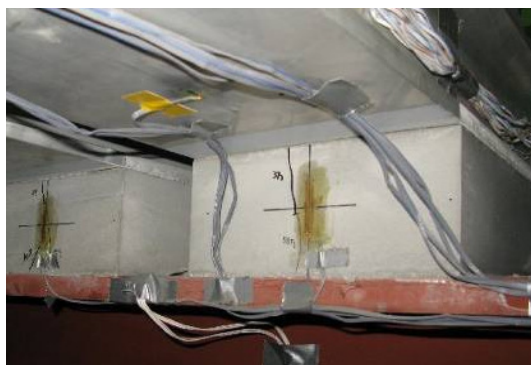
図42 台座モルタルの縦ひび割れ
