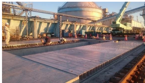
図 1.5 棧橋の取換え床版として導入されたアルミニウム床版
