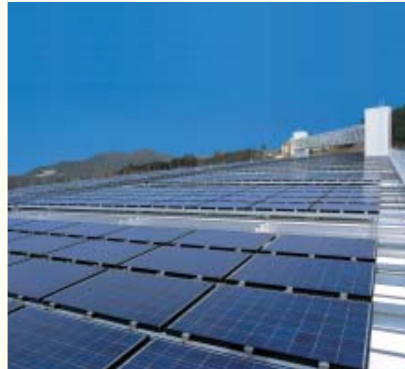
兵庫県の西播磨総合庁舎では、庁舎で使用する電気の大半を太陽光発電でまかなう。（財）新エネルギー財団平成14年度新エネ大賞経済産業大臣賞受賞。
