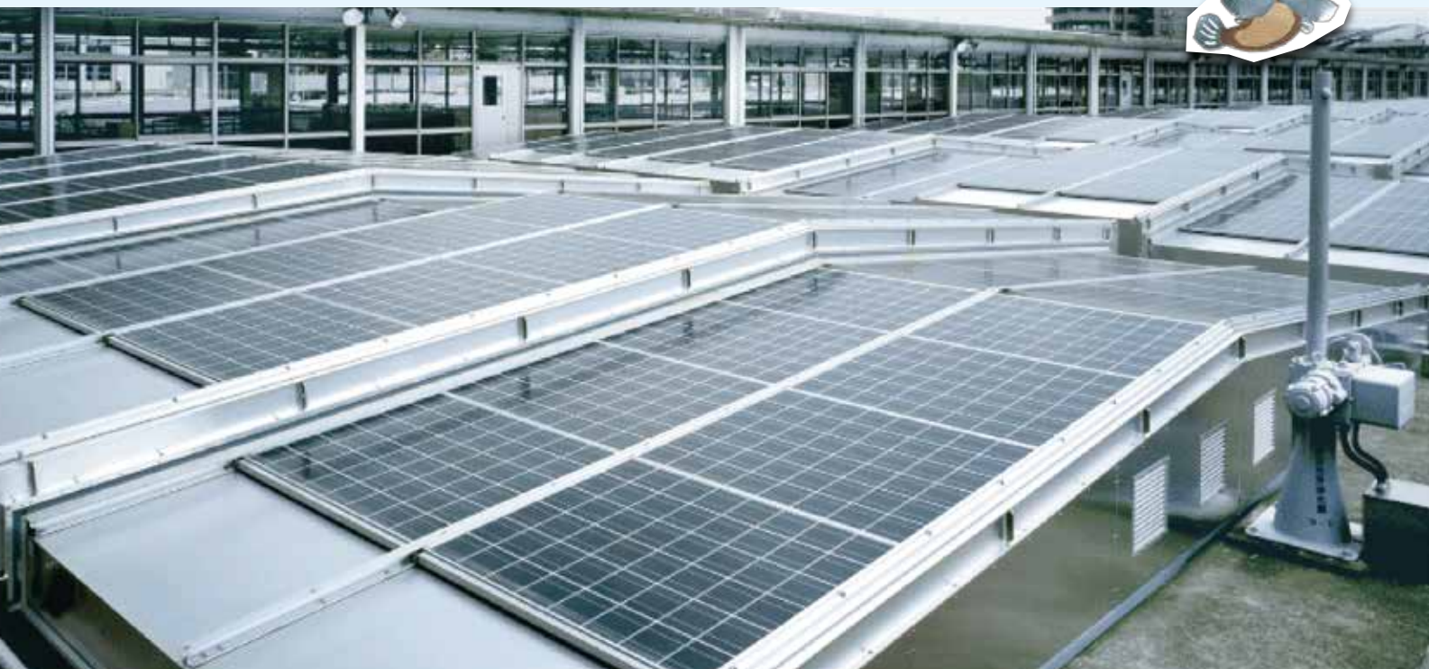
浄水槽を覆う蓋にソーラーパネルを付けるところもある。(埼玉県・朝霞浄水場)
