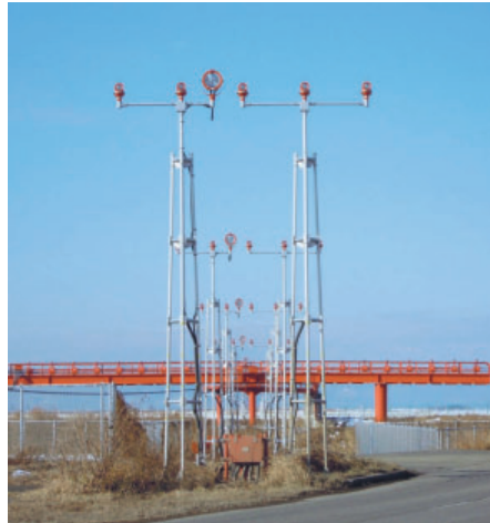
仙台空港進入灯柱（宮城県）
