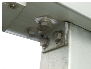
(a) 取り付けシートステンレス 来間大橋（設置後18年）
