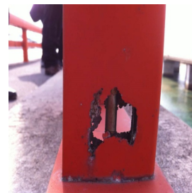
(c)バラスター中の鉄芯との接触腐食による孔食 (波之上橋, 設置後27年)
