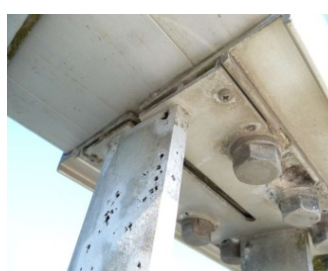
(e) 車両用防護柵取付シート 及びバラスター 源河橋（設置後25年）
