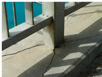
(a)アルミニウム合金支柱とコンクリート中の鉄筋との接触腐食による地覆の割れ
