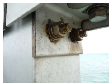
(c) 取り付けシートステンレスボルト部 池間大橋（設置後21年）
